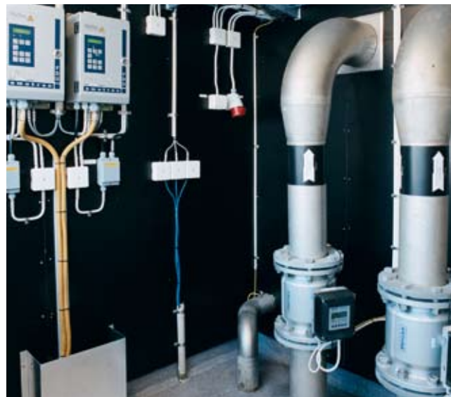
La mayoría de los equipos de la planta de tratamiento de aguas residuales de Svenljunga solían regularse manualmente. Tras la renovación todos ellos se regulan con productos de Emotron, como estas bombas de admisión.
