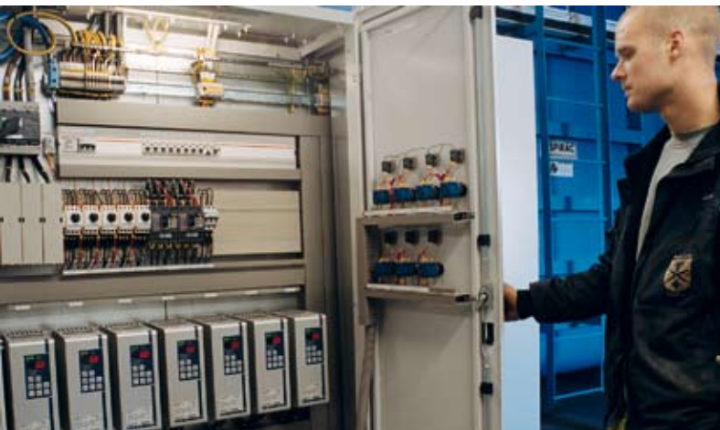
El lodo se deshidrata en centrifugadoras cuyos transportadores sinfín se controlan con siete arrancadores progresivos Emotron MSF. A continuación, el lodo se utiliza como fertilizante o se lleva a un vertedero.
