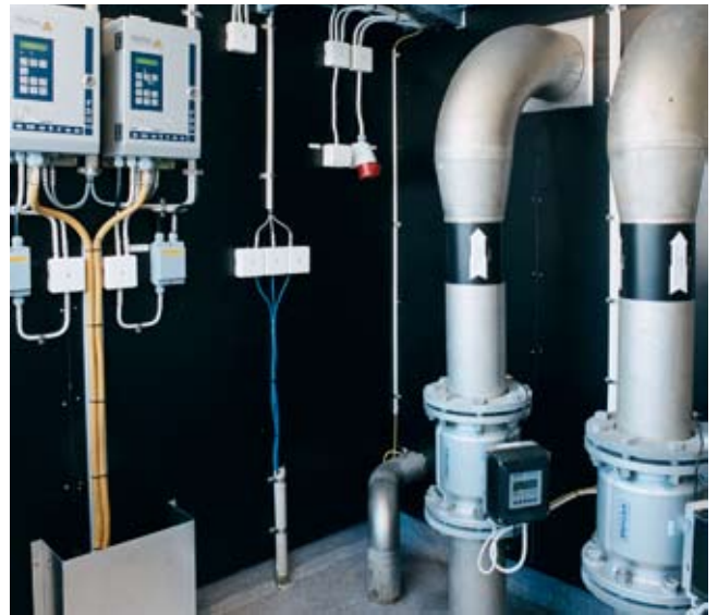
Svenljunga排水处理厂的设备过去在很大程度上是用人工控制。今天,所有的事情都由Emotron调节,比如那些进水泵。
