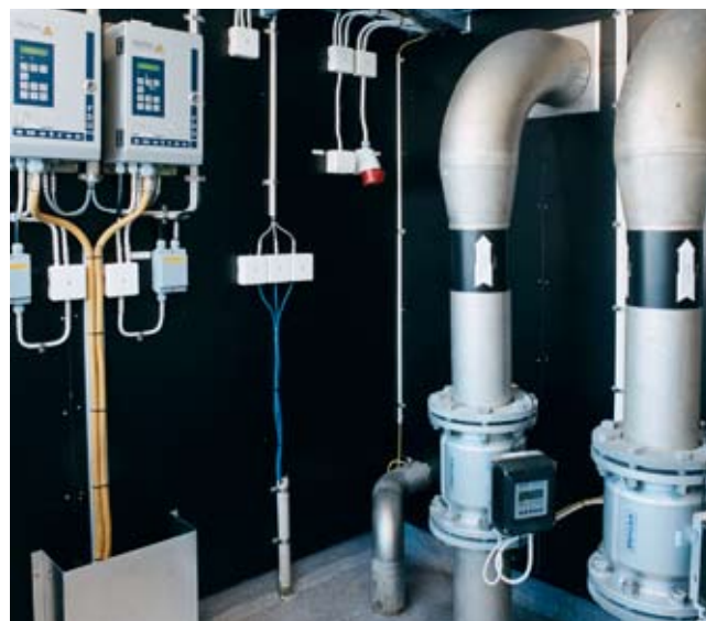
De apparatuur van de rioolwaterzuivering van Svenljunga werd vroeger grotendeels handmatig bediend. Tegenwoordig wordt alles geregeld door Emotron-producten, zoals bij deze inlaatpompen het geval is.
