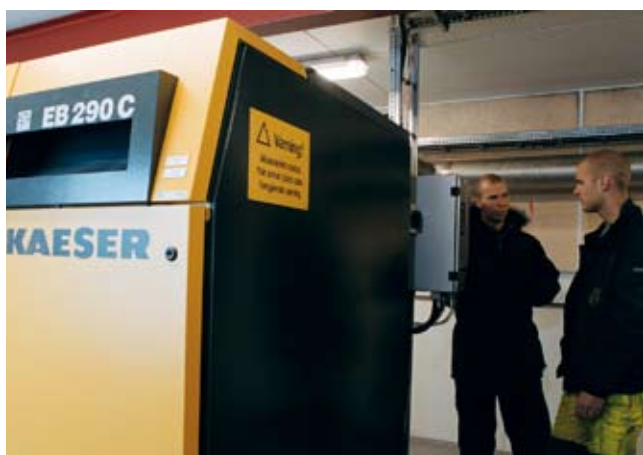
Het energieverbruik en de slijtage aan apparatuur zijn teruggedrongen door de blowers te regelen met frequentieregelaars van Emotron. Rechts ziet u Johan Arvidsson en links Peder Wale, verkoper bij Emotron.
