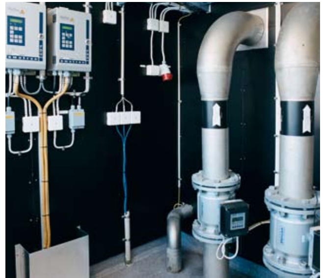
Die Ausrüstung im Klärwerk von Svenljunga wurde lange Zeit manuell gesteuert. Jetzt wird alles von Emotron Produkten geregelt, wie etwa diese Einlasspumpen.
