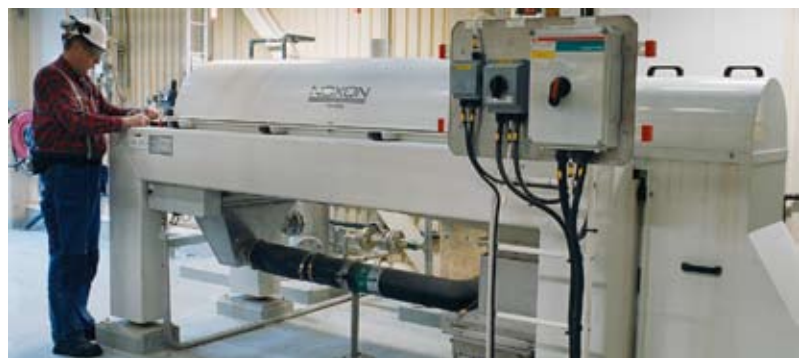
Gary Karvinen an einer Schlammzentrifuge im Klärwerk der Produktionsanlage, die ebenso wie die Gebläse zum Anreichern des Abwassers mit Sauerstoff von Emotron Frequenzumrichtern gesteuert werden.
