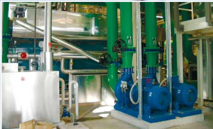
Deze koelwaterpompen worden gebruikt om de luchtvochtigheid in een drukkerij op het gewenste niveau te houden.
